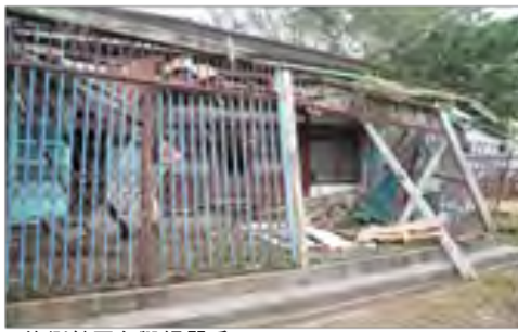
■緣側外平台毀損嚴重
